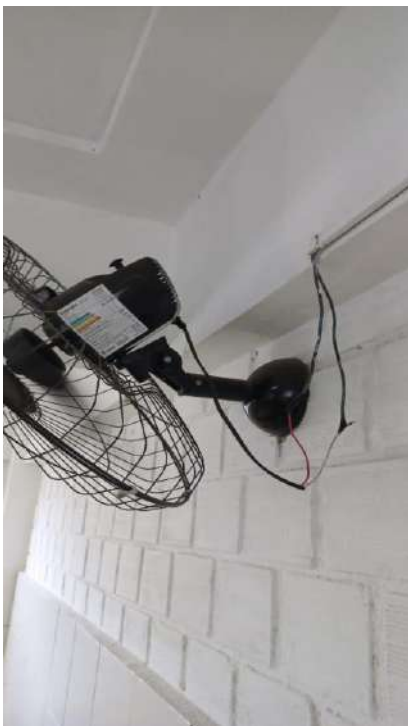
Foto 77. Instalações elétricas expostas
