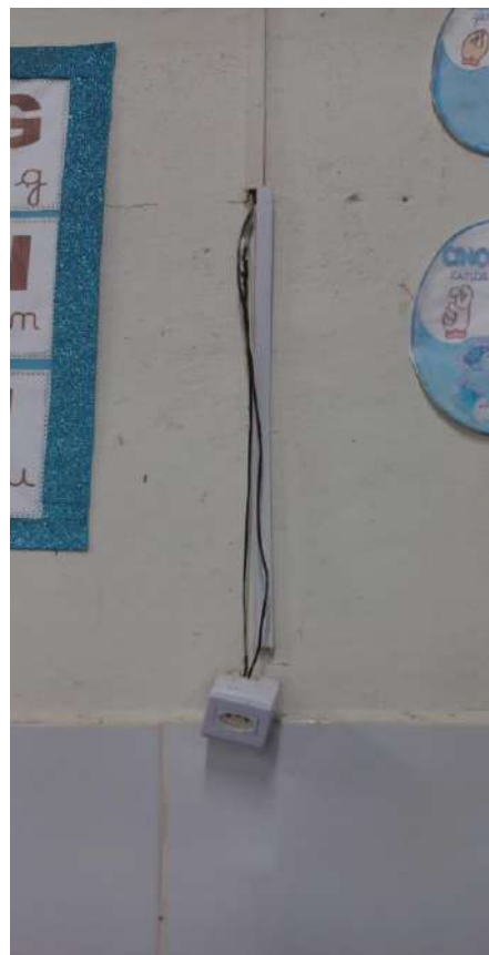
Foto 44. Instalação elétrica inadequada
