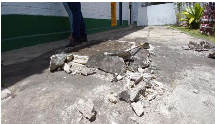
Foto 51. Tampa do poço danificada e poço vazio necessitando de escavação
