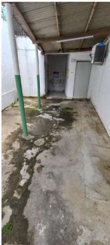
Foto 76. Água escorre do banheiro
