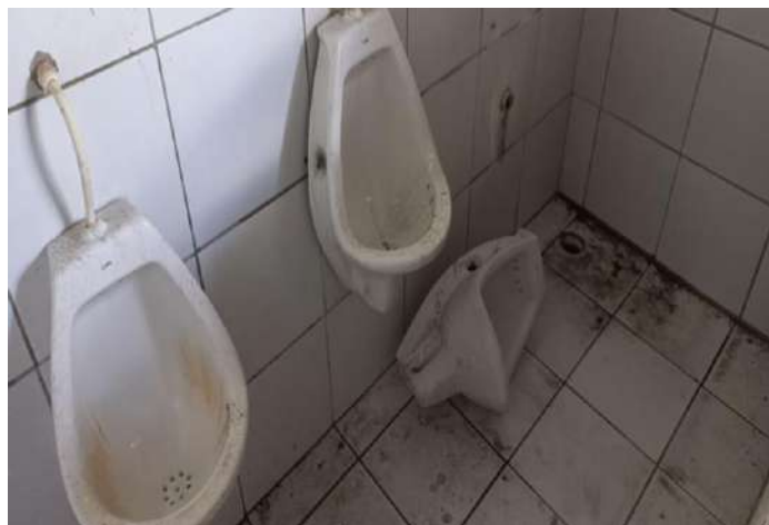
Foto 68. Mictórios quebrados e sem água
