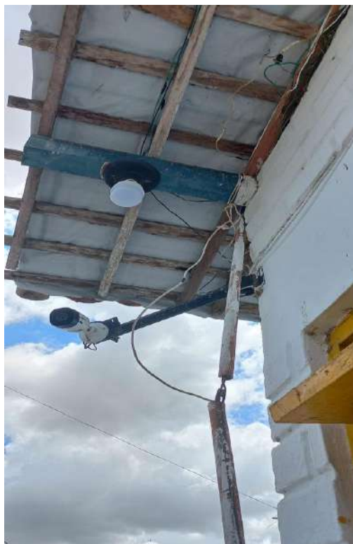
Foto 52. Elétrica antiga onde ocasionou início de incêndio
