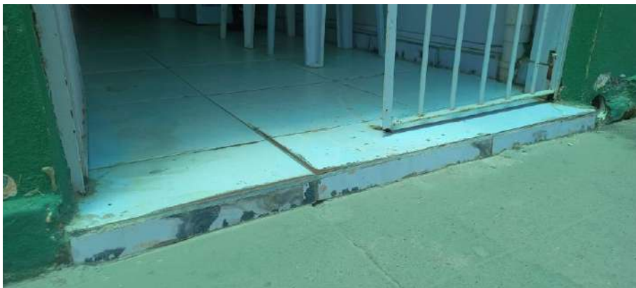
Foto 62. Entrada principal sem acessibilidade
