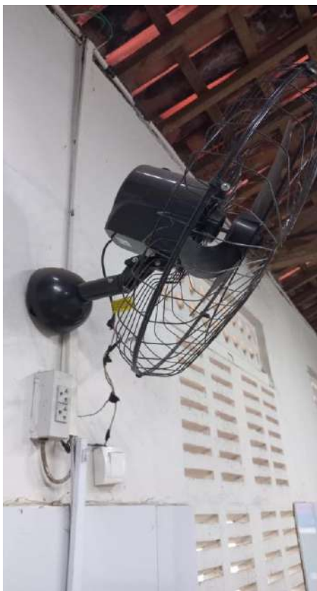
Foto 43. Instalação de ventilador inadequada
