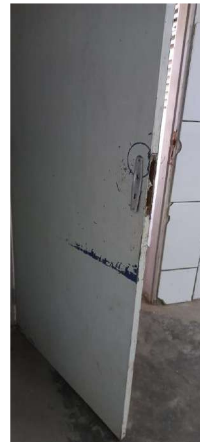
Foto 42. Porta quebrada e sem fechadura
