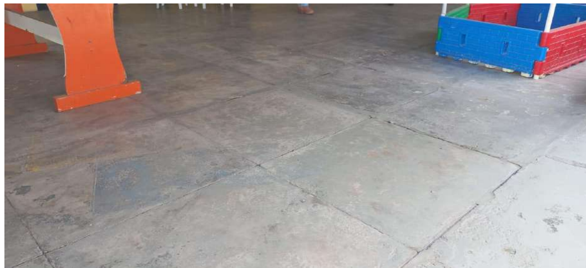
Foto 55. Piso do pátio soltando vidros
