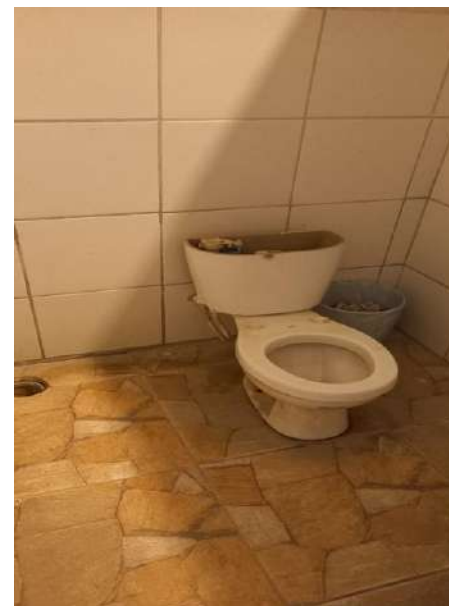
Foto 69. Descargas quebradas e sem água
