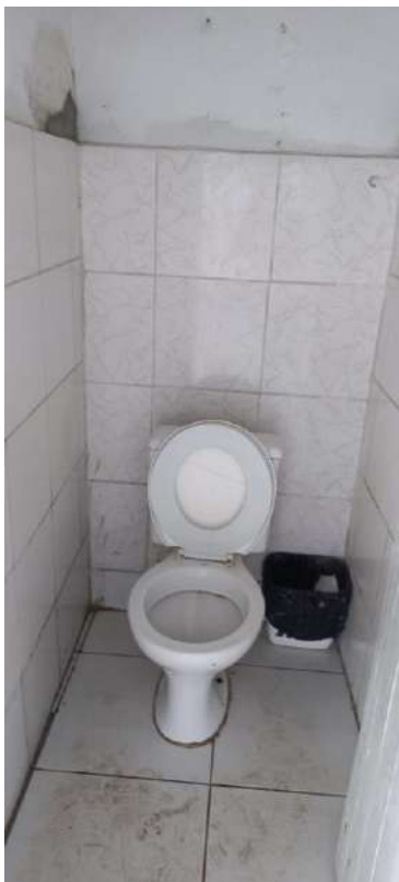
Foto 72. Banheiro sem acessibilidade e sem barra de apoio
