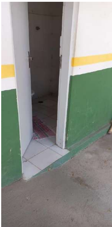
Foto 56. Ausência de acessibilidade aos banheiros
