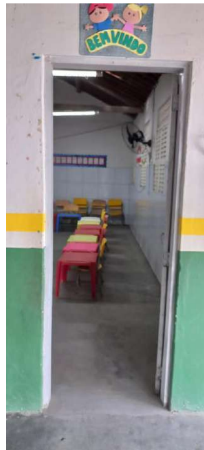
Foto 41. Porta sem acessibilidade
