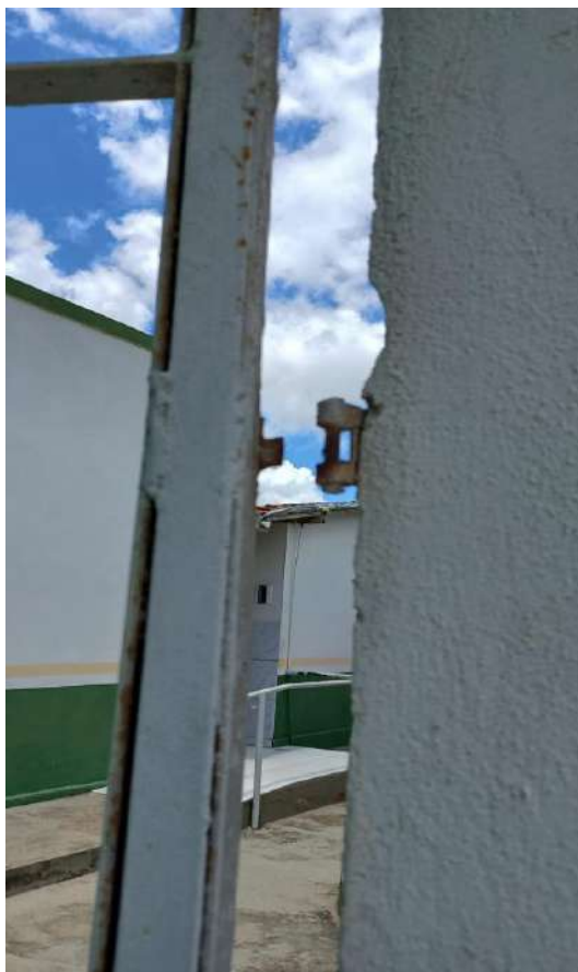
Foto 65. Portão da Entrada principal necessitando reparo
