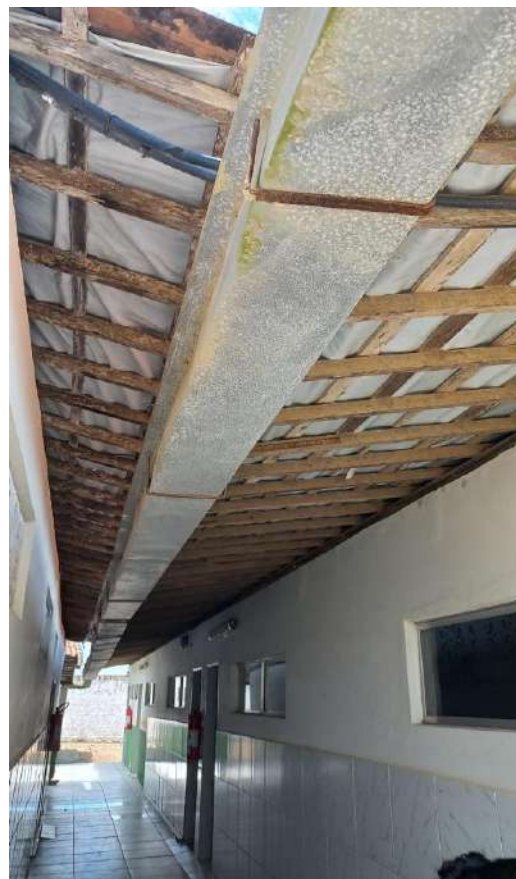
Foto 66. Biqueira de água não suporta o volume de água em dias de chuva
