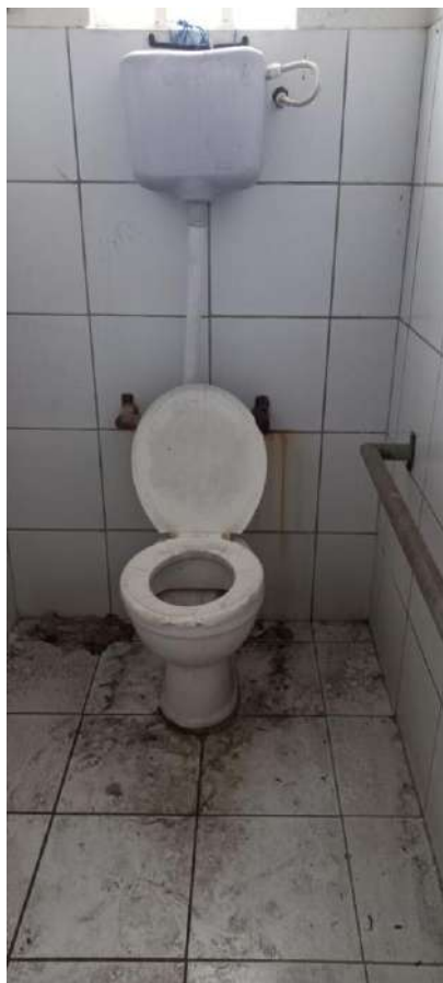
Foto 67. Descargas quebradas e sem água
