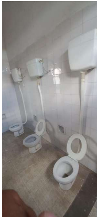
Foto 48. Banheiros entupidos e sem tampa do vaso
