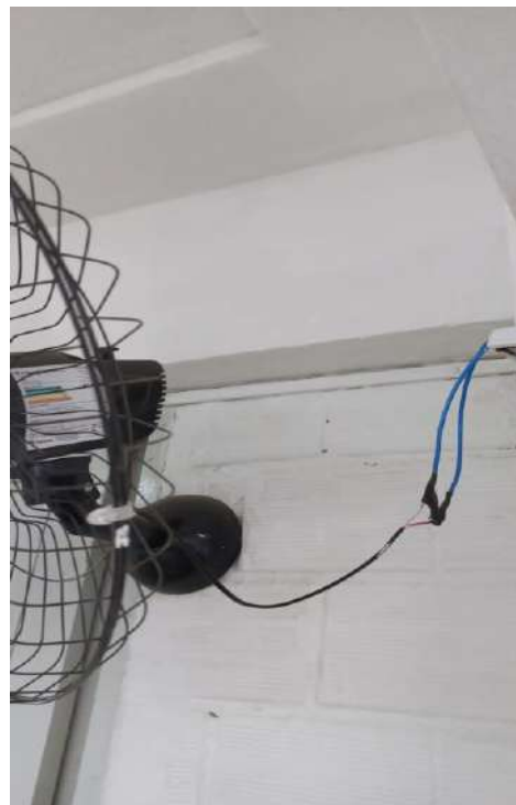
Foto 78. Instalações elétricas expostas
