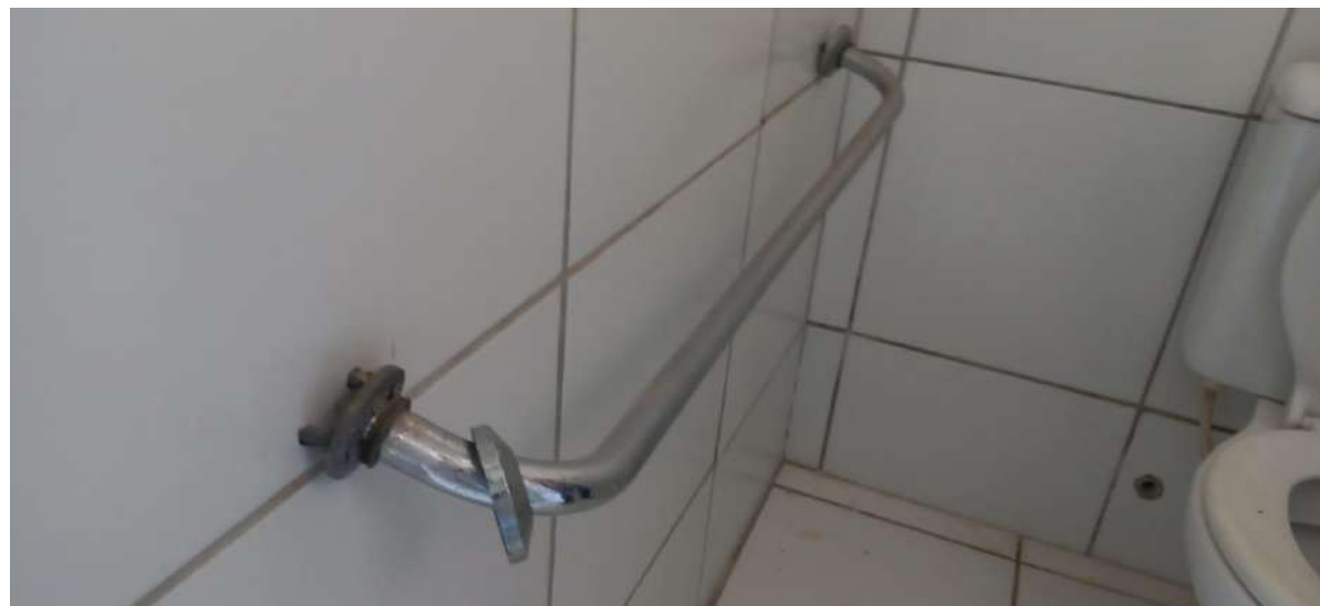
Foto 57. Barra de apoio danificada
